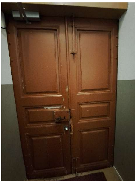
Sakastin ovesta on mahdollisesti murtojälkiä.
