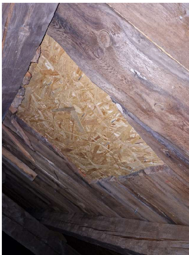
Yläpohjatilassa on vesikatolle vievä kulkuluukku ummistettu mahdollisesti edellisen vesikattoremontin yhteydessä.
