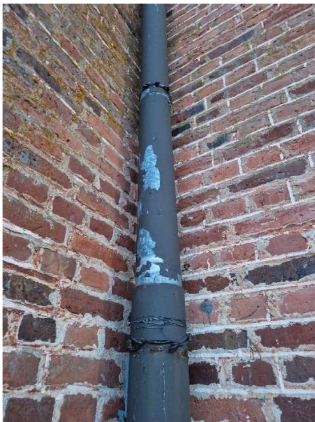
Osa syöksytorvien pinnoitteista on hilseillyt.
