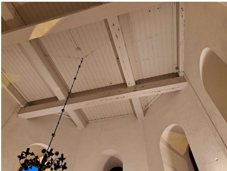
Puupalkkien maalit hilseilevät
