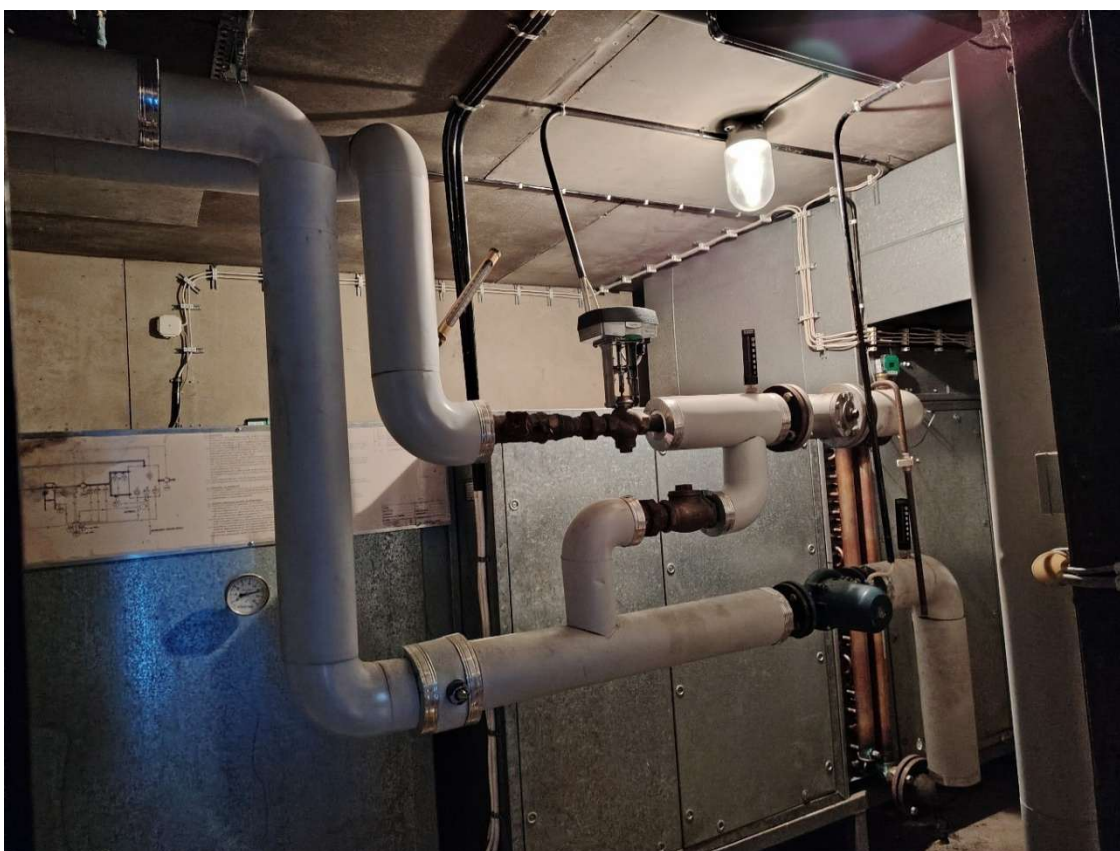
Lämmönjakuhuone sijaitsee vanhassa viinikellarissa.
