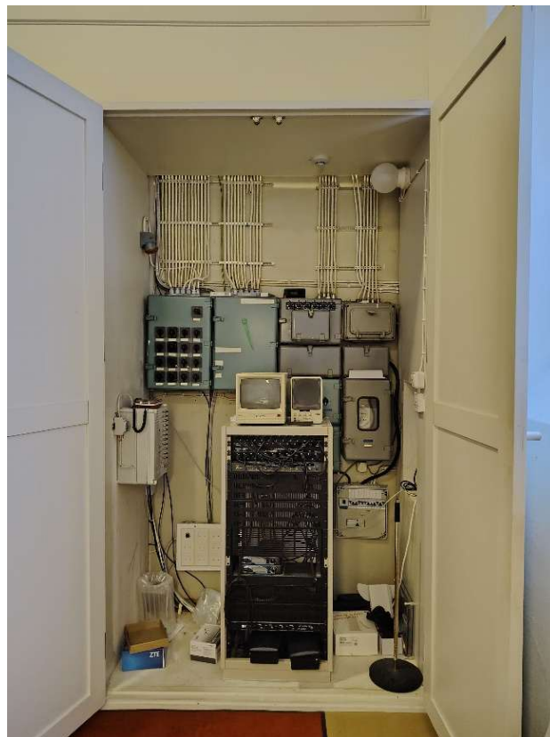
Sähköpääkeskus sijaitsee sakastissa.
