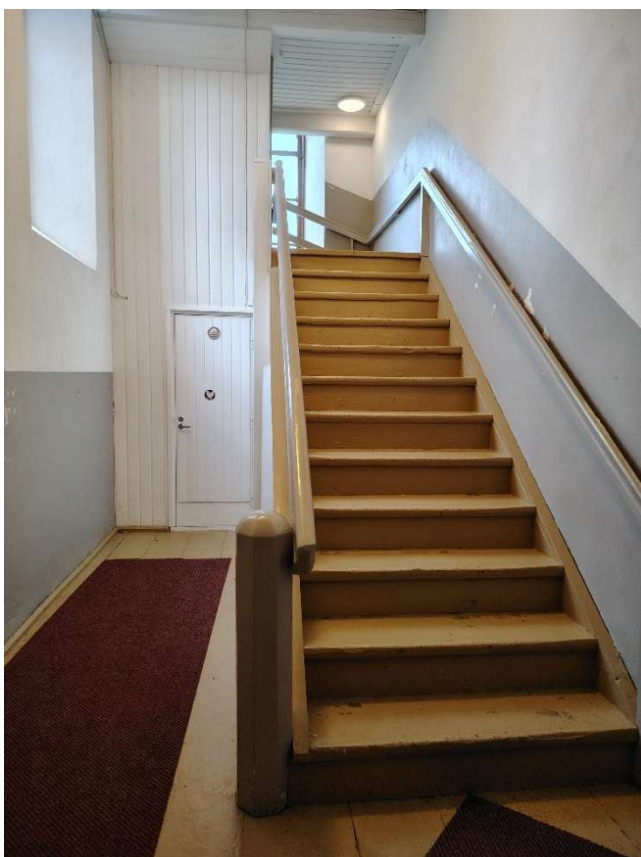
Kirkon luoteiskulman porraskäytävässä olleeseen komeroon rakennettiin WC-tilat miehille ja naisille vuonna 1972. Myös sakastin yhteyteen rakennettiin WC.
